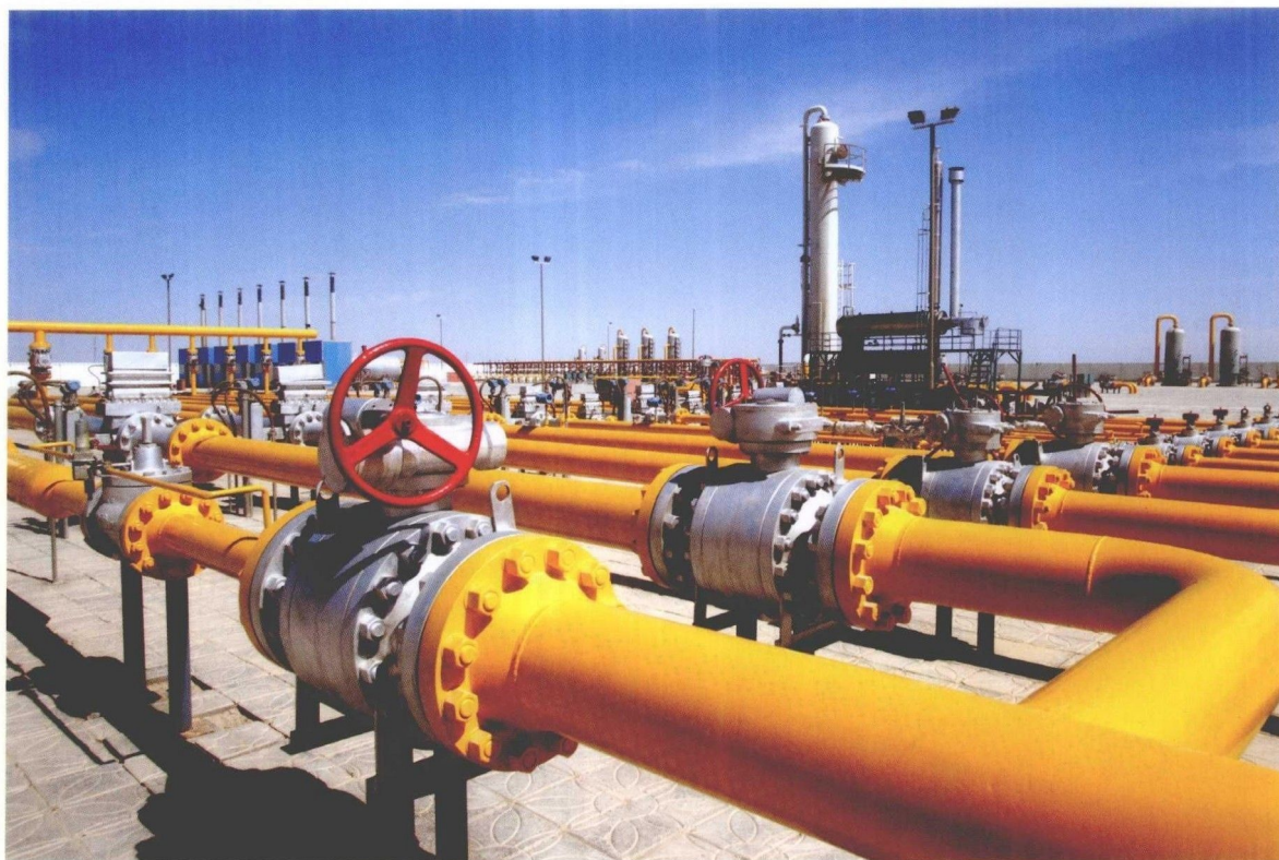
中国石油天然气集团公司全年生产天然气 683 亿立方米，销售天然气 594 亿立方米，同比分别增长 10.7% 和 13%。图为现代化的青海涩北气田自动化无人值守集气站
