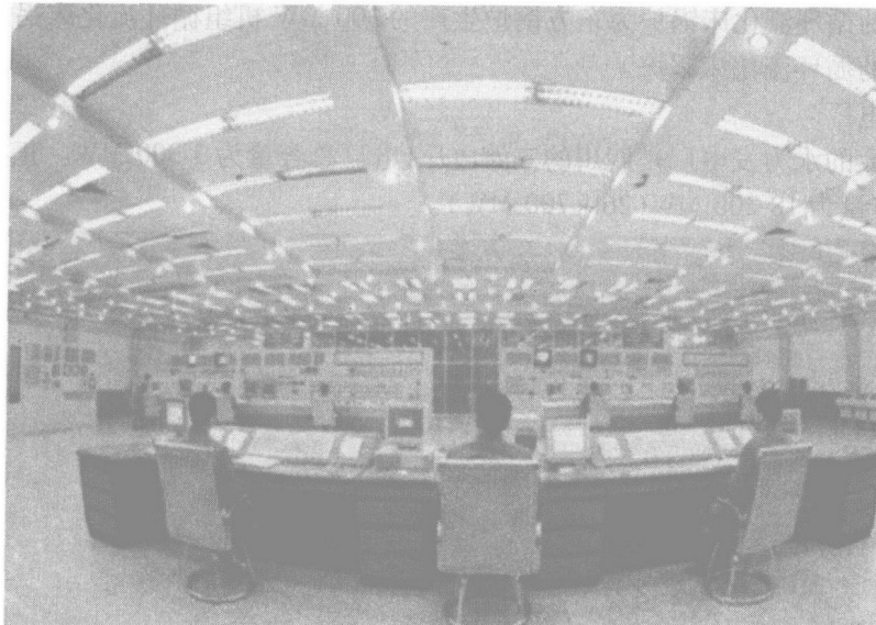
火电厂集控室
