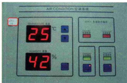
图1-1-1 提前开启洁净空调系统
