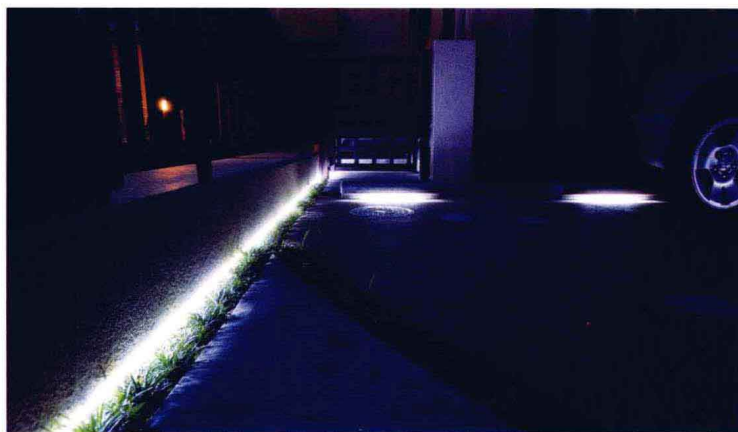
▲ 车挡处，边界地带装设LED照明灯，为车辆夜间出入提供方便。
