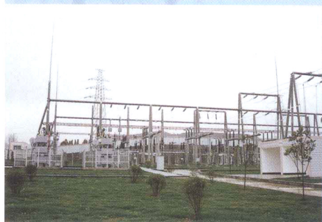
毕节 220KV 变电站图一
