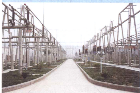
毕节 220KV 变电站图二
