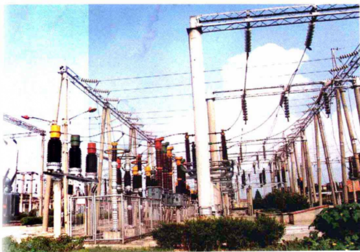
县 11 万千伏变电所
