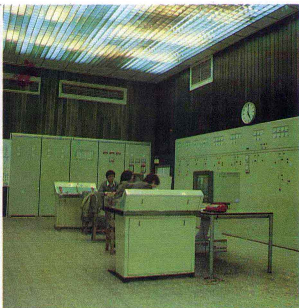
国家重点工程鲁布革电站主控室
