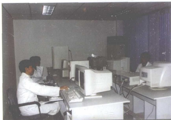
主控制中心机房
