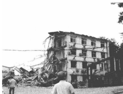
图 1-10 汉旺车风汽轮机厂未经加固 办公楼破局部倒塌
