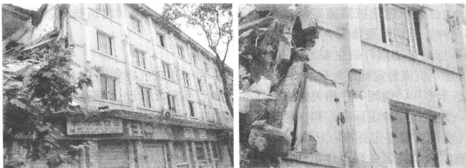
图 1-15 加固措施不到位造成结构局部坍塌
