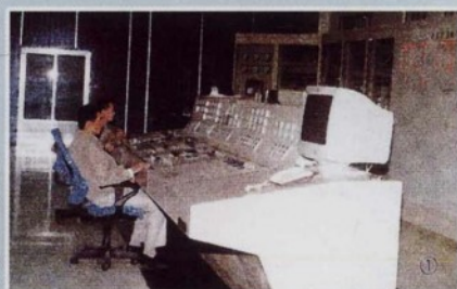
新源糖厂中心控制室
