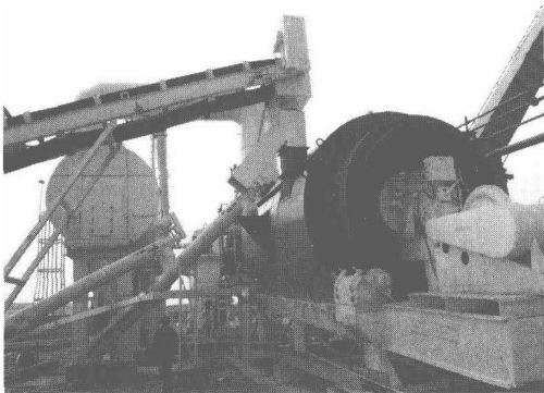
图 1-11 广佛高速公路厂拌热再生拌和厂
