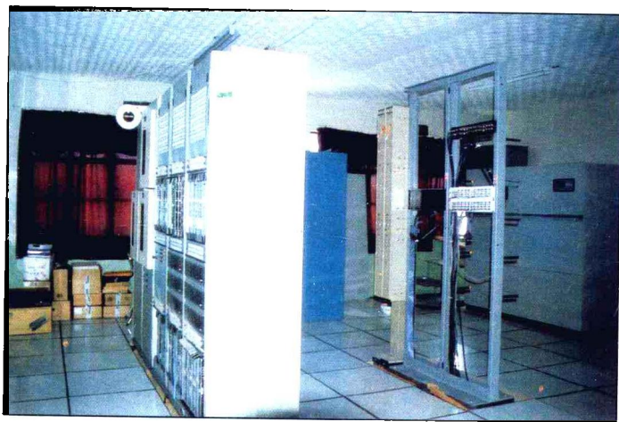
阿里地区移动通信机房
