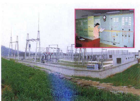
11 万伏变电站全貌及机房一角
