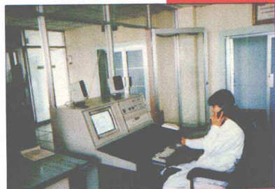
大连大显集团、大连电子研究所研制开发的高速公路监控指挥中心系统
