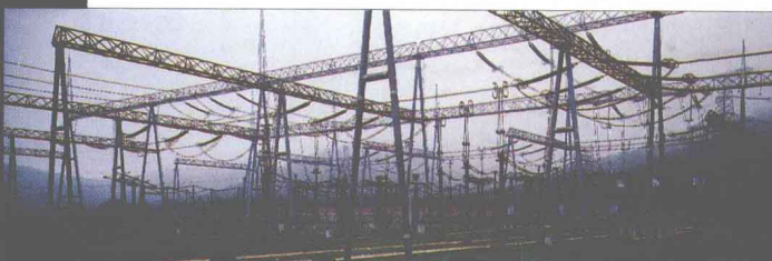
引进安装了意大利具有世界先进水平的500KV大型无功磁调压自耦变压器
