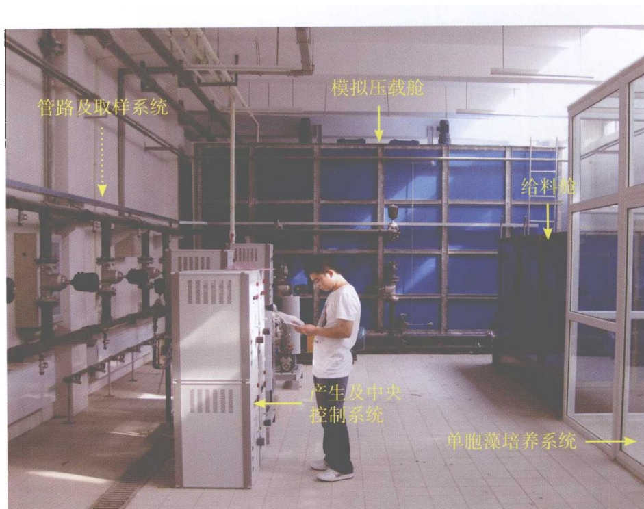
A. 50 t/h 压载水处理试验系统总体结构
