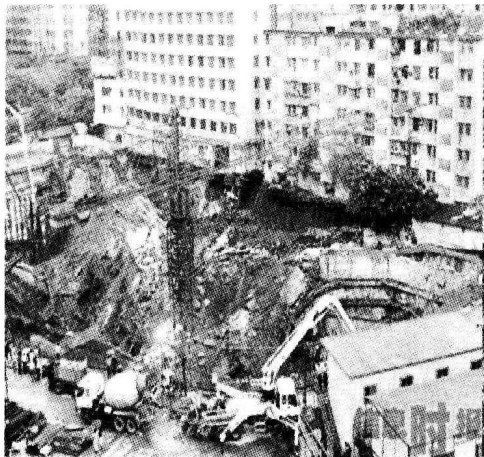
图 0-4 广州地铁三号线基坑垮塌事故
