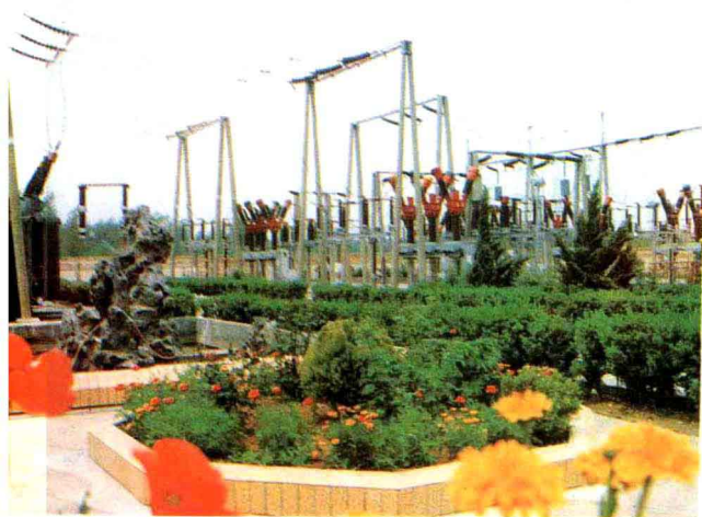
18. 县供电局变电所
