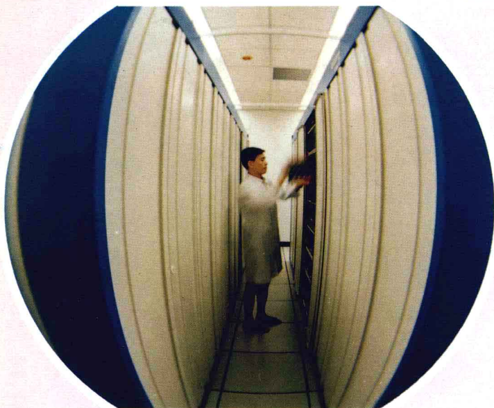
程控电话交换机机房
