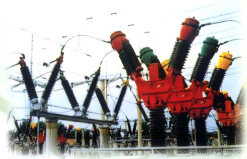
220 千伏输变电工程
