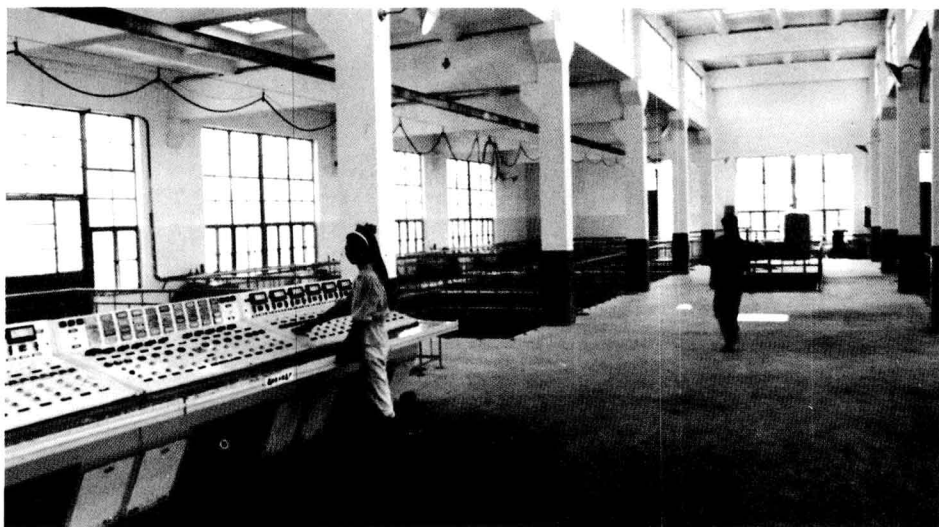
白廟水廠快濾池一角
