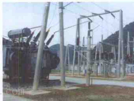
谷硐110千伏变电站
