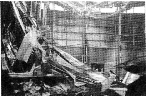
图 1-3 蒙牛冷库钢结构倒塌
