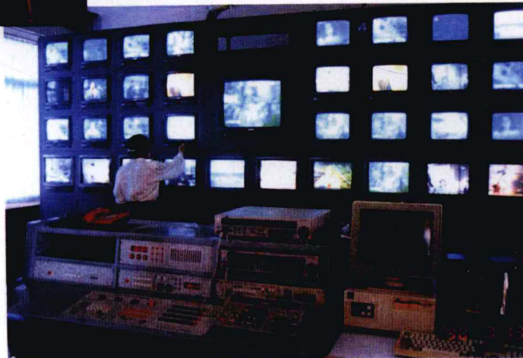
莒县有线电视台播控机房
