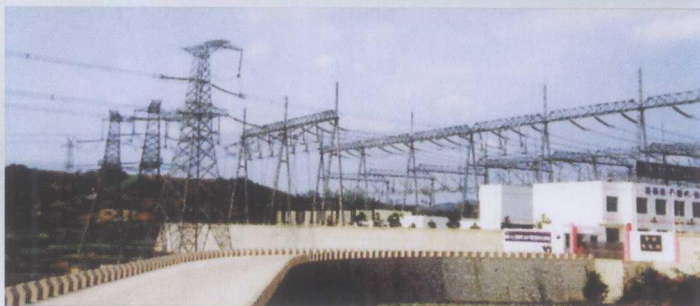
2002年12月,500千伏青岩变电站建成投运
