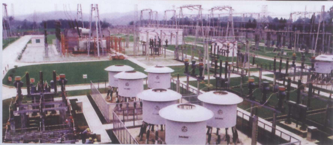
2001 年 7 月，500 千伏鸭溪变电站建成投运
