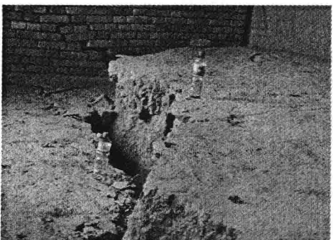
(g) 滑坡后缘拉裂缝一
