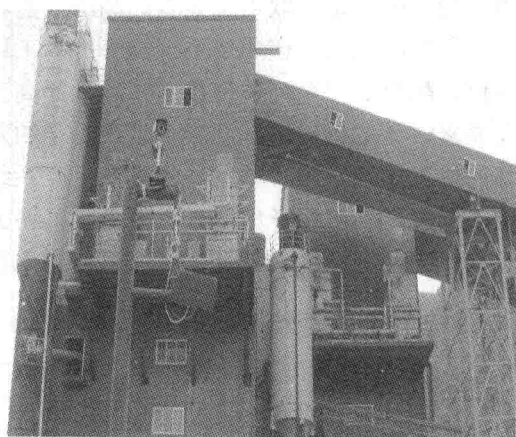
图2 藏木水电站混凝土生产系统新增的石粉罐
