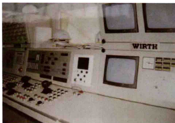
TBM 操作控制室
