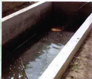
● 彩图16 温室蓄水池
