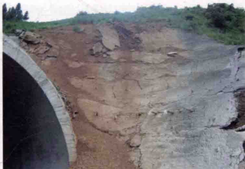
图2-2 施工中隧道仰坡坍塌
