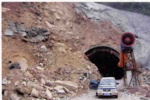
图2-3 施工中隧道边、仰坡坍塌
