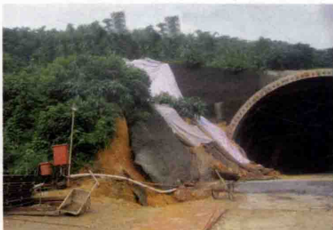
图2-1 施工中隧道边坡坍塌
