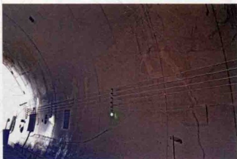
图2-7 明洞衬砌边墙出现斜向裂缝
