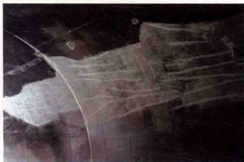
图2-6 明洞衬砌拱部出现纵向裂缝
