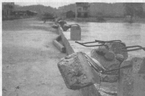
b)洪水将桥梁上部结构冲毁
