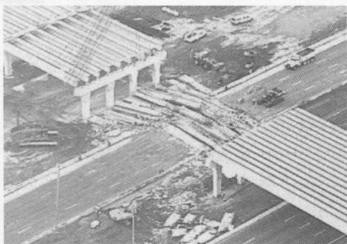
图 1.2 飓风 Katrina(2005)所造成的桥梁破坏
