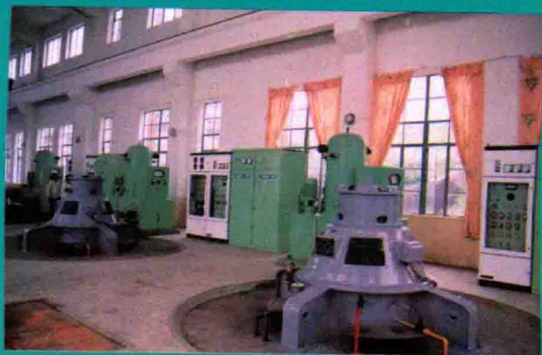
►《要电找建行》——兴 宁支行支持建成的合水电 站发电机组。(李旋安摄)
