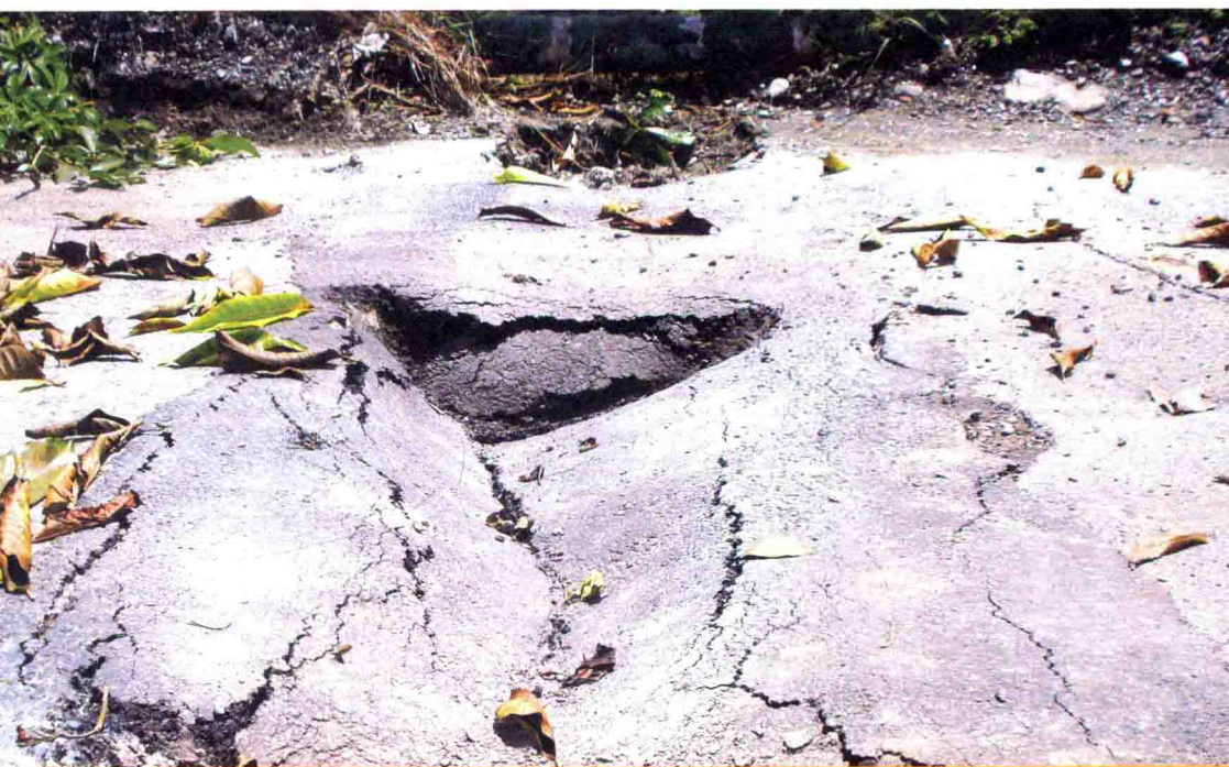
● 搶水工程龜裂土地。（提供：反中科搶水自救會）
