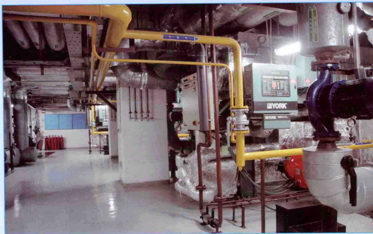
写字楼的直燃机机房
