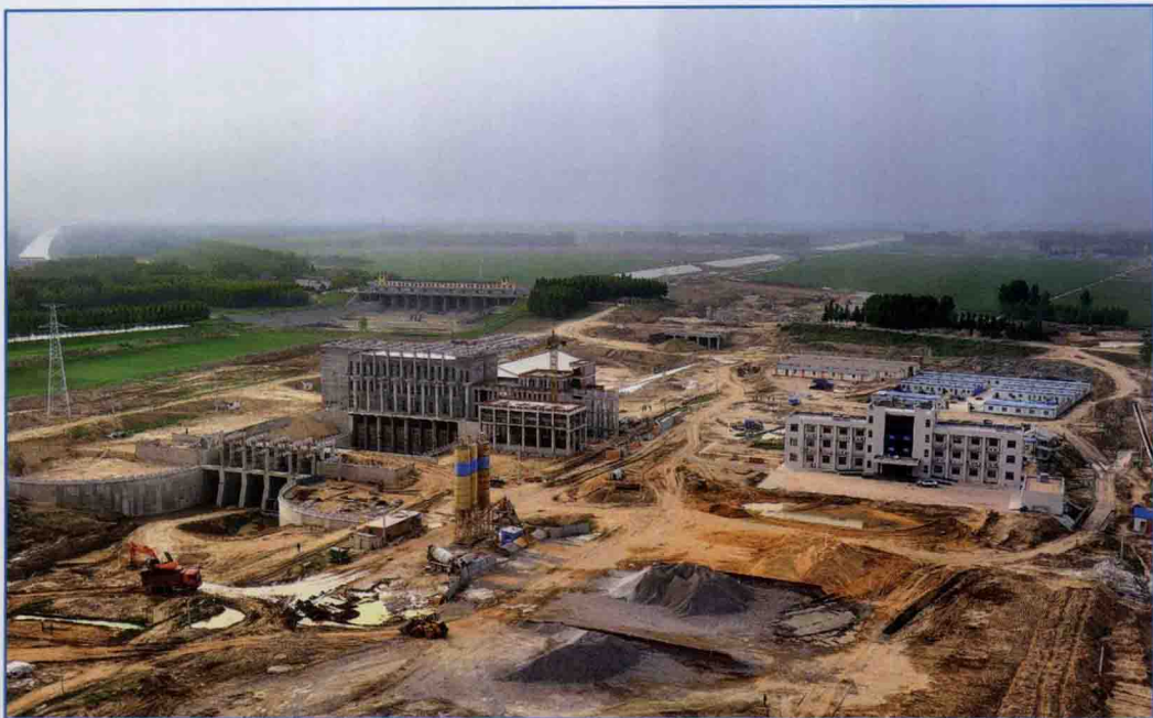
■ 2012年4月，南水北调东线一期工程邓楼泵站工程正在紧张施工。
