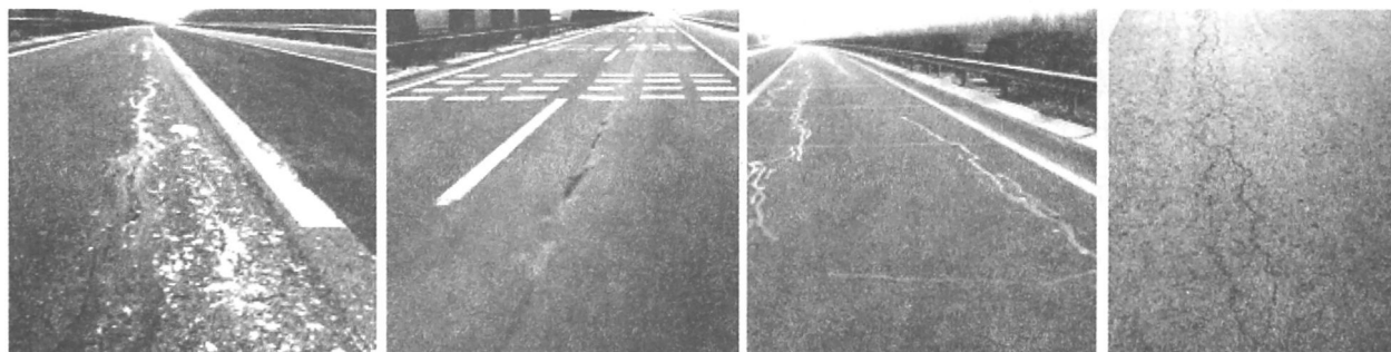
严重纵向裂缝
