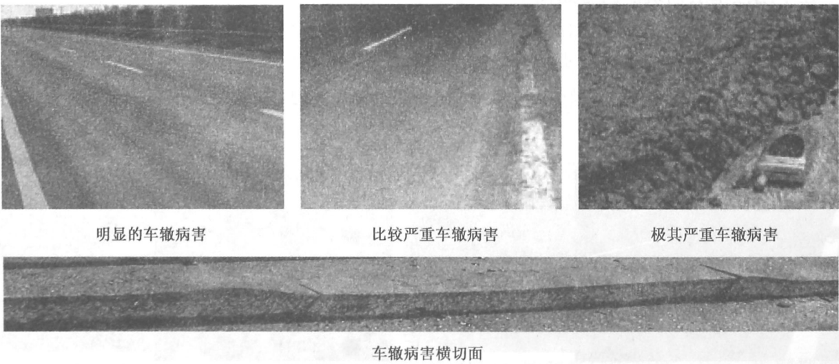
图 0-1 沥青路面车辙病害工程实例
