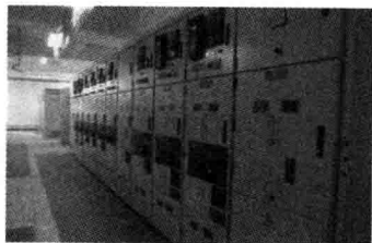
(b) 10 kV 开关柜
