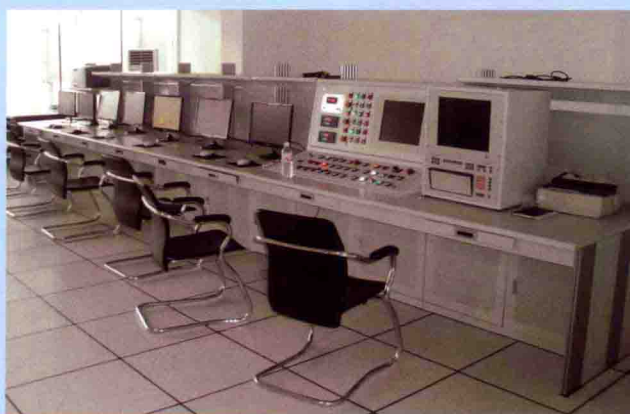
中央控制监测室
