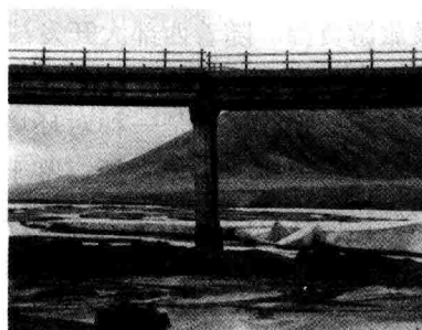
图 1.4 多年冻土融化大桥中心桥基下沉
