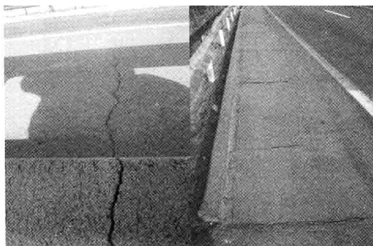
图 1-9 涵洞台背交界处的路面裂缝
