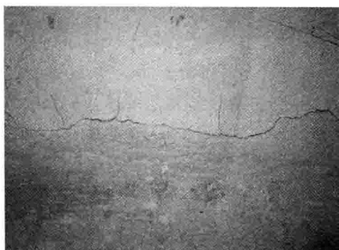
图 1-7 混凝土拱涵拱脚部位的纵向裂缝
