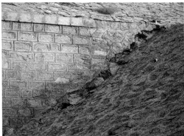
图 1-14 浆砌片石护坡与路堤交界处破坏
