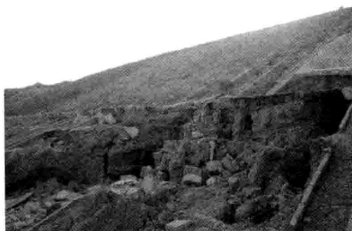
图 1-3 路堤坡脚冲毁
