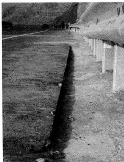
图 1-4 涵顶路堤沉降
