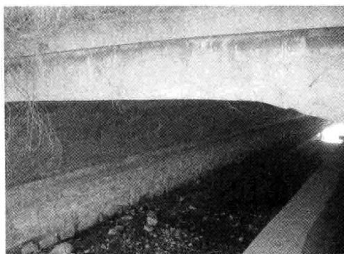
图 1-11 涵洞内部积水
