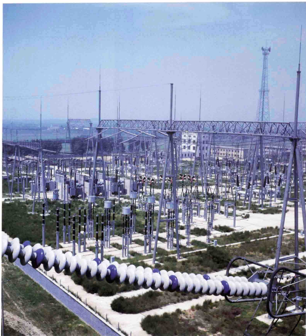
北京房山 500 千伏变电站
