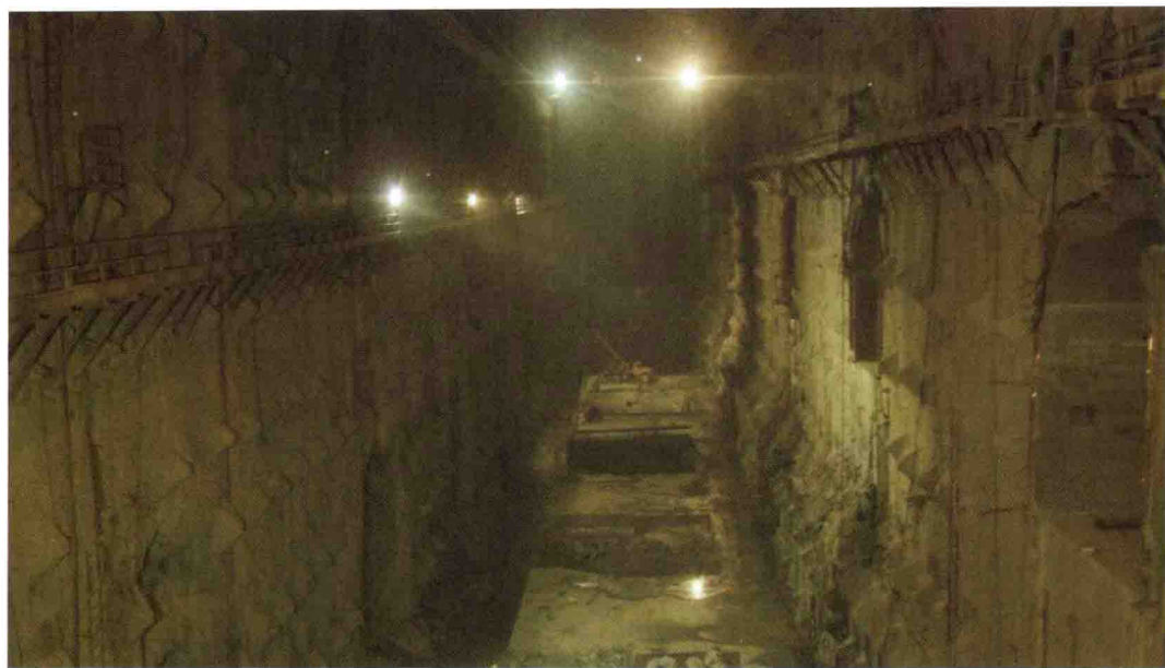
锦屏一级地下厂房
