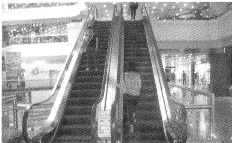
图 1-2-1 安装在商场的普通自动扶梯
