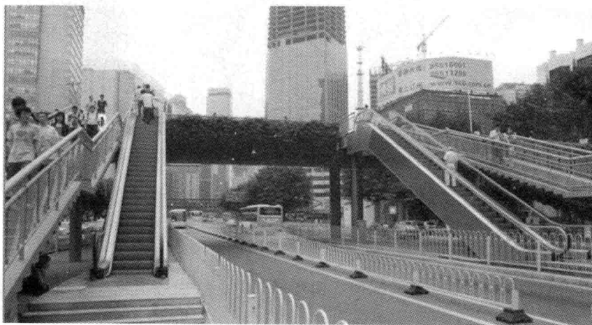
图 1-2-2 安装在过街天桥上的公共交通型自动扶梯
