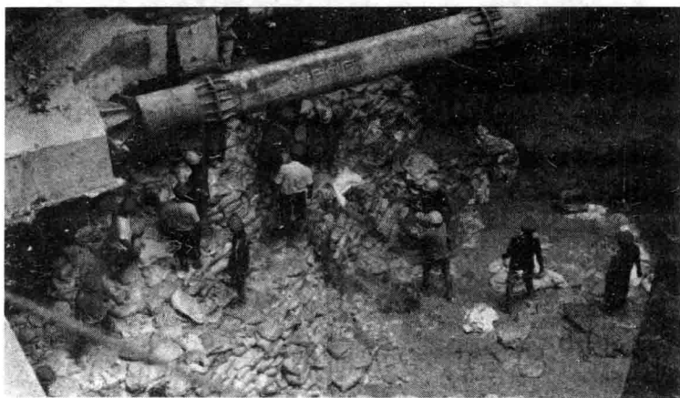
图 1-1 地下水影响施工
