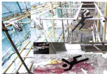
粉刷外墙 不慎坠落
