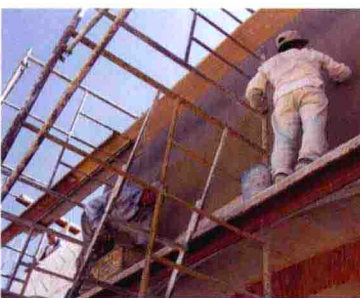
从安装结构上坠落
