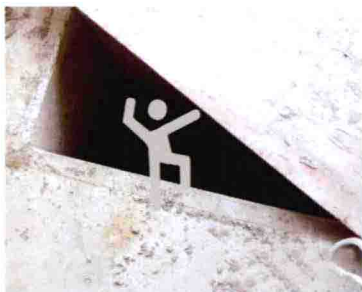
隐患未除 引发坠落
