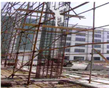
防护不力 造成坠落
