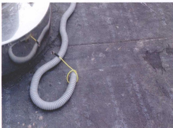
3 GNSS 天线线缆及护管照片
