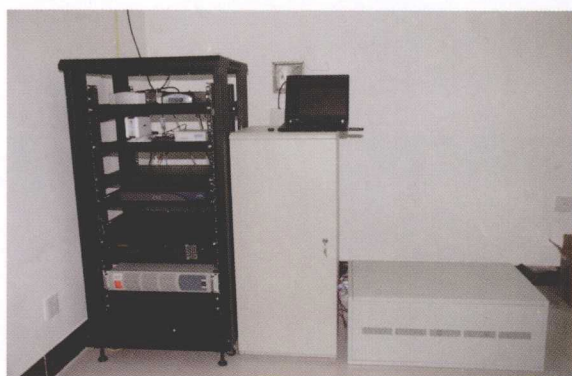
14 观测室整体照片 （安装完成后机柜、直流电池柜、ups 电池柜、标墩）
