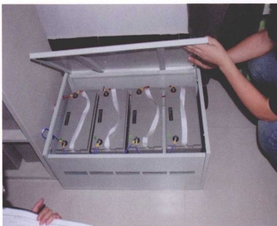
5 直流不间断电源电池组 (电池与连接线, 无顶盖时)
