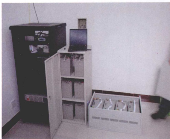
7 交流不间断电源电池组 (电池与连接线, 无顶盖时)
