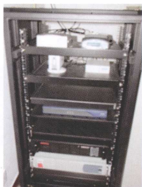
13 机柜前部整体照片（安装完成后）
