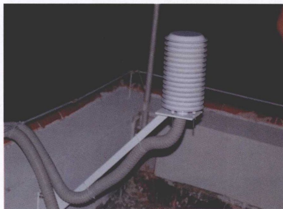
4 气象仪室外部分照片（支架、防辐射罩、线缆及护管）
