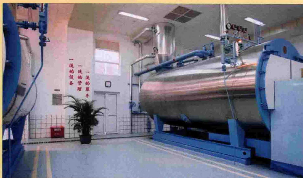
大型燃气锅炉
