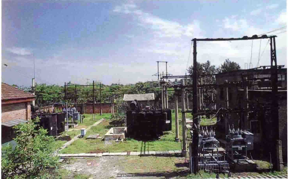
始建于 1938 年的 35 千伏长辛店变电站
