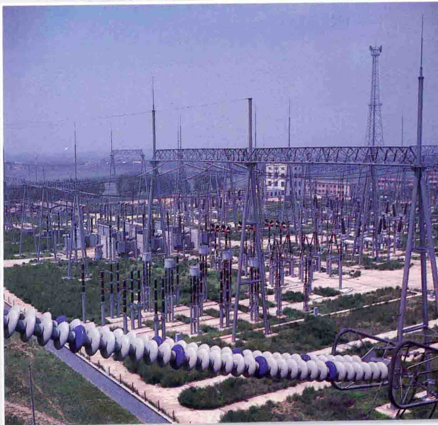
俯瞰 500 千伏房山变电站
