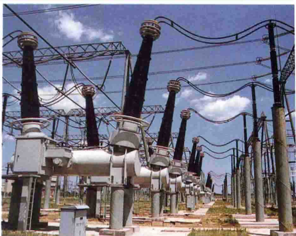
500 千伏房山变电站六氟化硫开关
