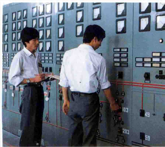
变电运行人员在倒闸操作
