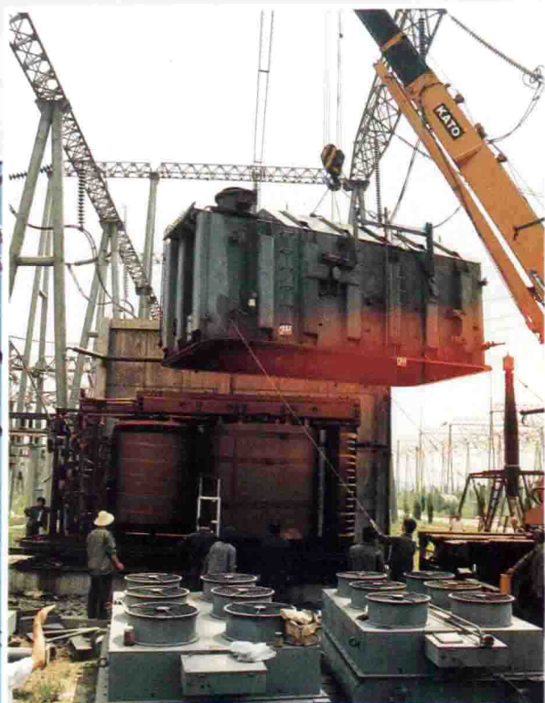
检修房山变电站 500 千伏主变压器
