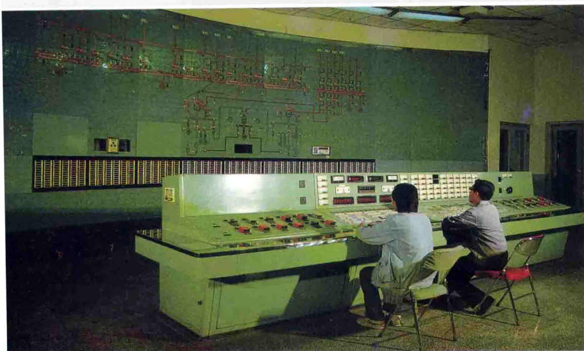
500 千伏房山变电站 220 千伏主控室
