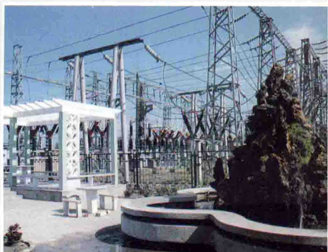
220 千伏老君堂变电站设备区
