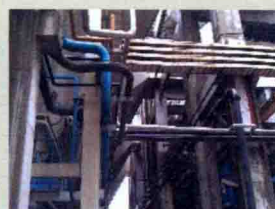
6. 除灰渣水系统管道
