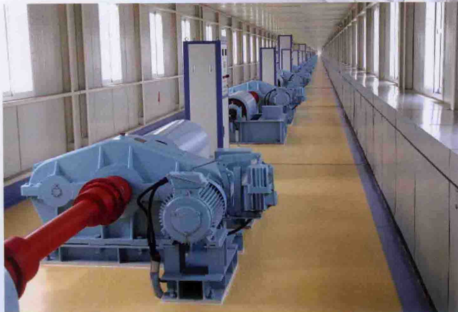
独流减河进洪闸启闭机房内景
