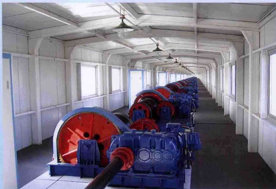
潮白新河宁车沽防潮闸启闭机房内景
