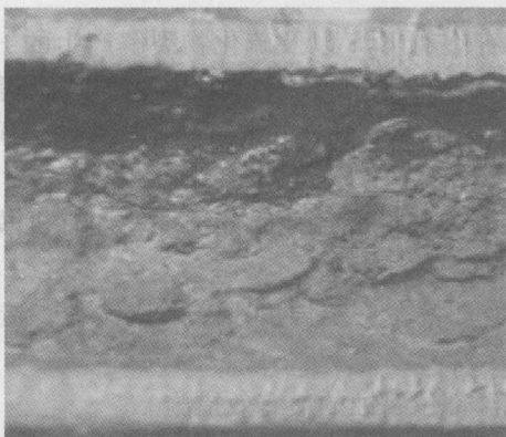
图8 铵盐沉积引起垢下腐蚀
